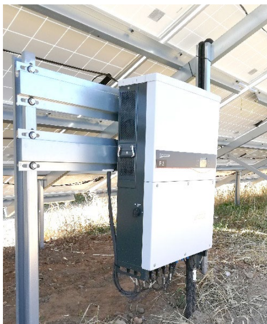
Fotografia 1 Przykładowy inwerter zlokalizowany pod panelami fotowoltaicznymi
