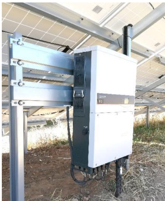
Fotografia 3 Przykładowy inwerter zlokalizowany pod panelami fotowoltaicznymi
