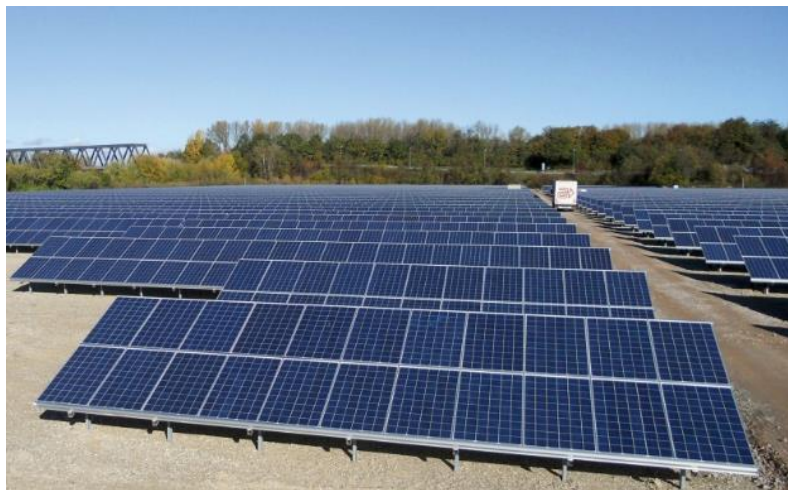
Fotografia 6 Elektrownia fotowoltaiczna w Iffezheim (źródło: http://www.wuerth-solar.de/solar/de/wuerth_solar_2012/unternehmen_1/referenzen_4/referenzen_12/referenzen.php 05.11.2012)
