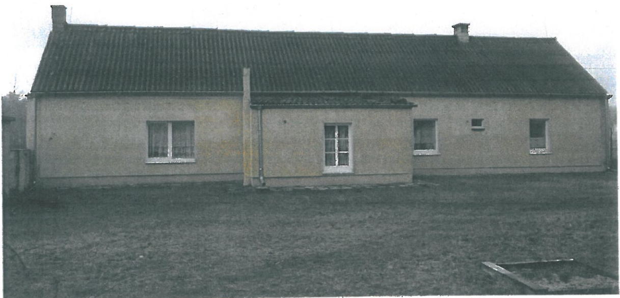
Zdj. Nr 2 Elewacja budynku od strony południowo – zachodniej. Widoczne pokrycie dachu płytami azbestowo – cementowymi
